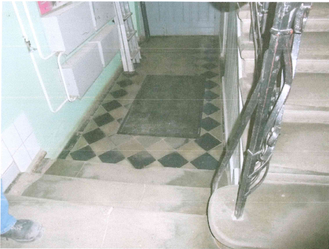
47. attēls. Sākotnējais grīdas flīzējums 1.stāva gaitenī pie pagalma ieejas (telpa nr.16).
