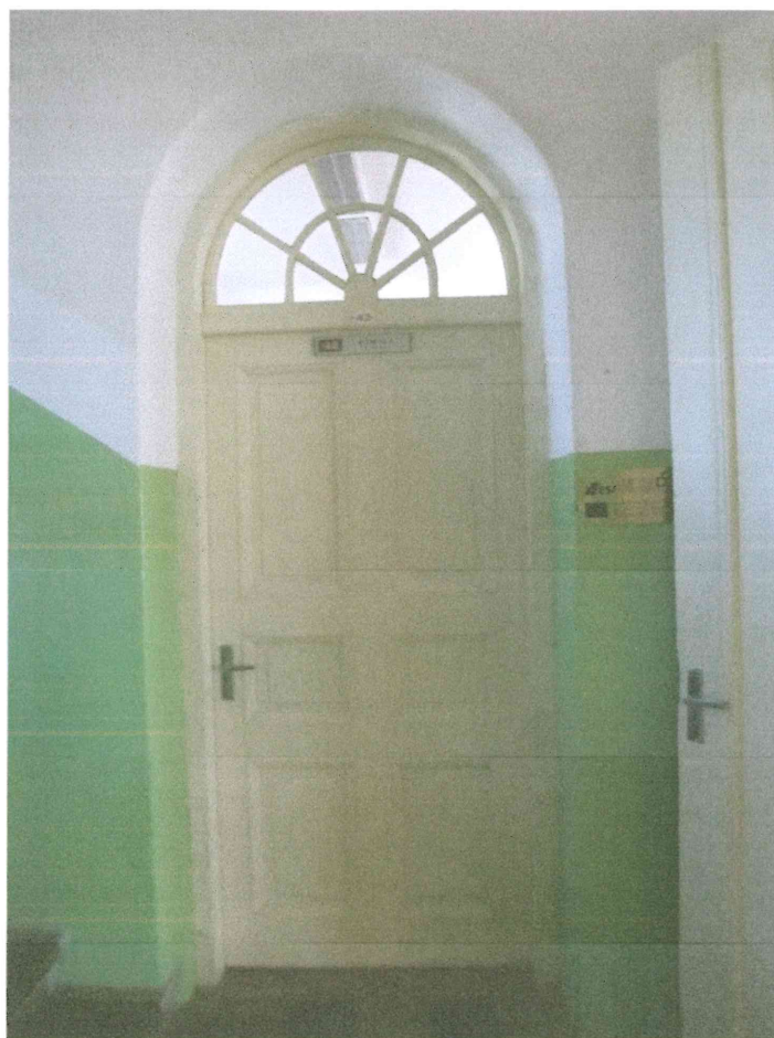
29. attēls. A korpusa 3.stāva pildīņu durvis D-A301 ar virslogu.
