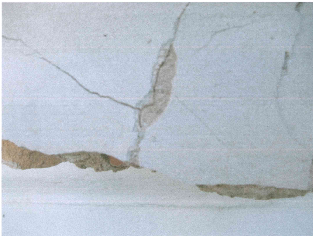
13.attēls. Bojātā 1.stāva loga ārējā palodze B korpusa ziemeļu fasādē .
