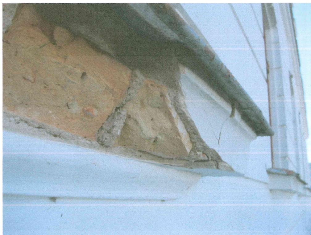
14.attēls. Ārsienas plaisas B korpusa ziemeļu fasādē.
