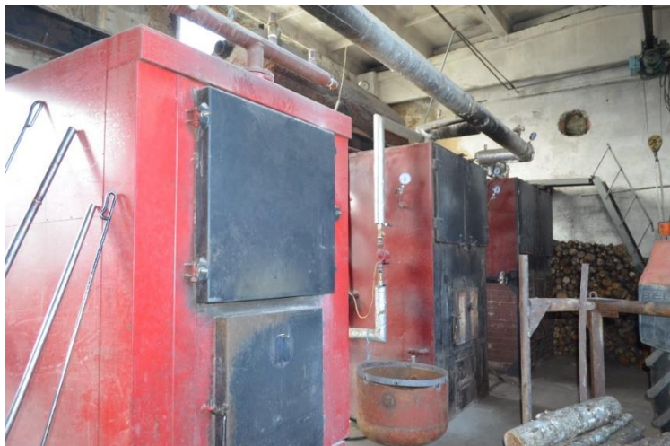
3.2.1.att. Staru katlu mājā uzstādītie malkas apkures katli
