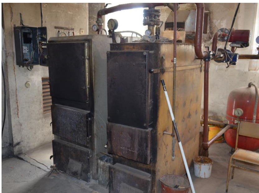
3.6.2.att. Pagasta pārvaldes ēkā uzstādītie apkures katli
