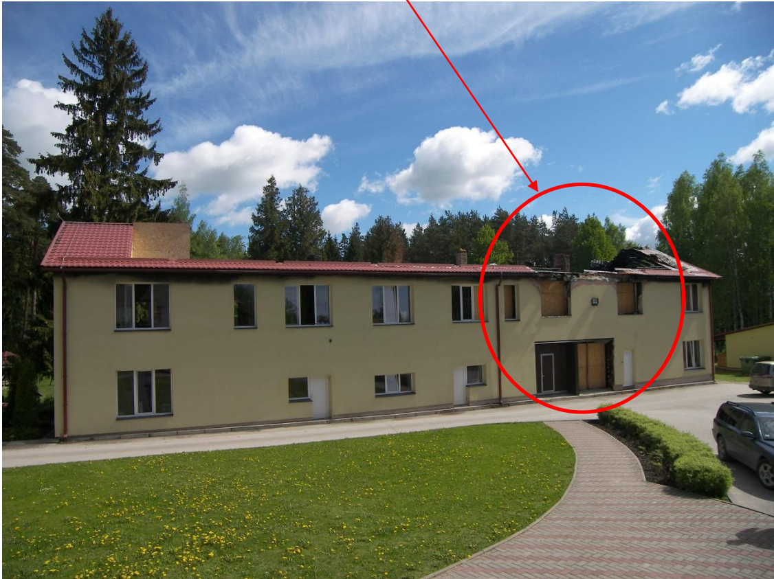
Foto Nr. 11 Visvairāk bojātā ēkas daļa
