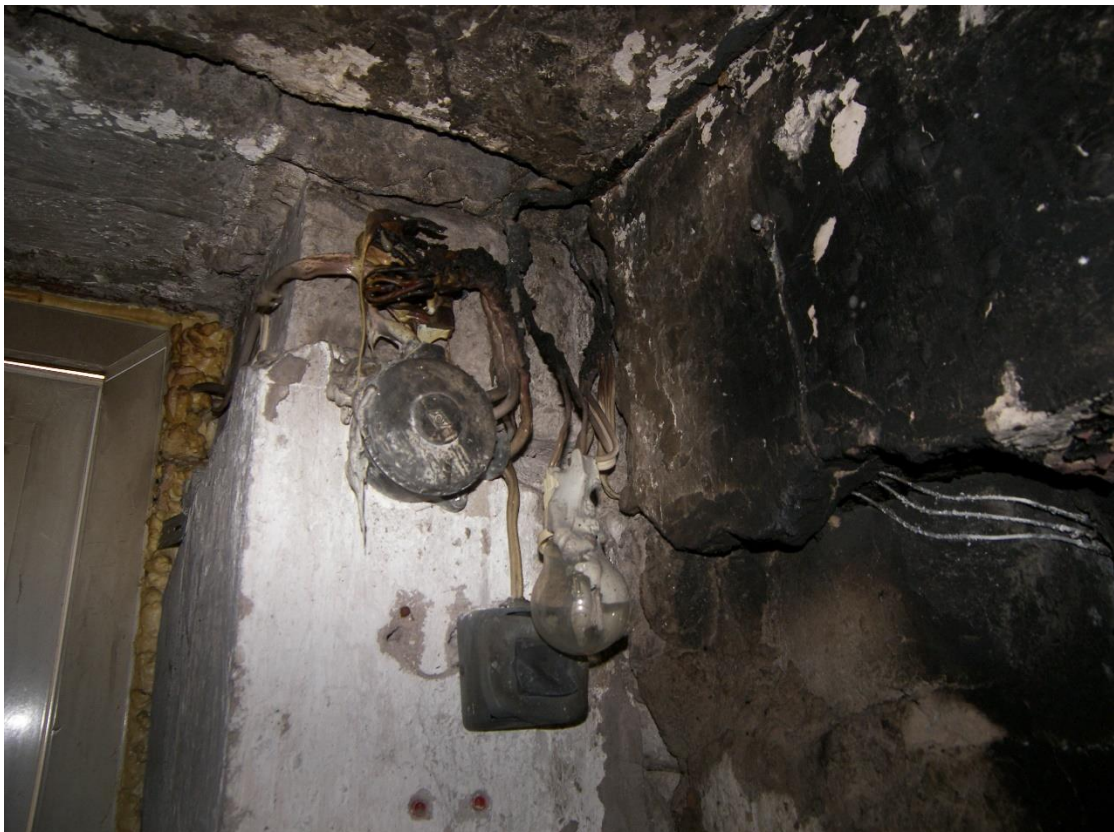
Foto Nr. 12 Morāli un fiziski nolietojusies iekšējā elektroinstalācija.
